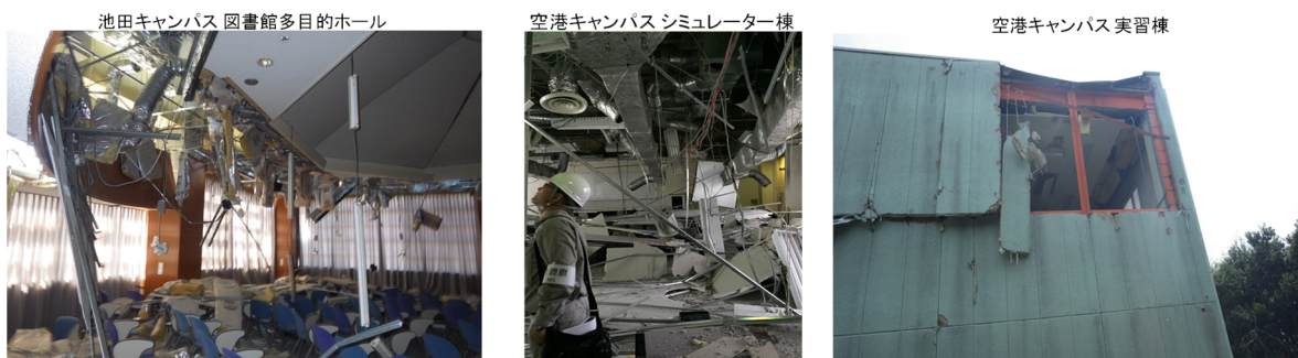
図 V-1 熊本地震による本学の被害
